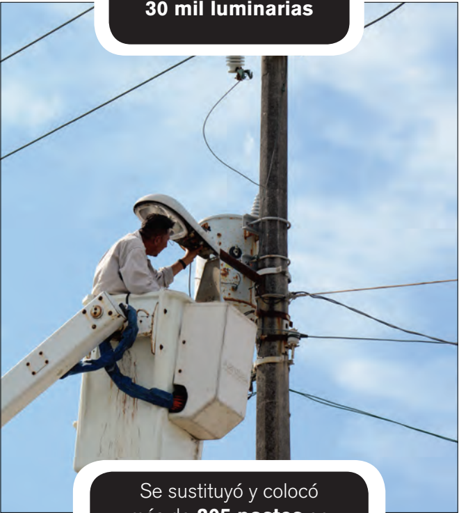
Reactivamos y rehabilitamos más de 30 mil luminarias
