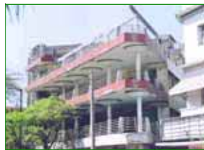
Edificio moderno en mal estado, en la esquina de las Calles de González Pagés y Callejón del Pípila. Este edificio perteneció al Sindicato de Tablajeros y actualmente hay un restaurante en planta baja y las plantas superiores se encuentran desocupadas. Por su representatividad y valor estético se considera necesario el rescate de este inmueble para ocuparlo nuevamente, lo cual contribuiría a su conservación.
