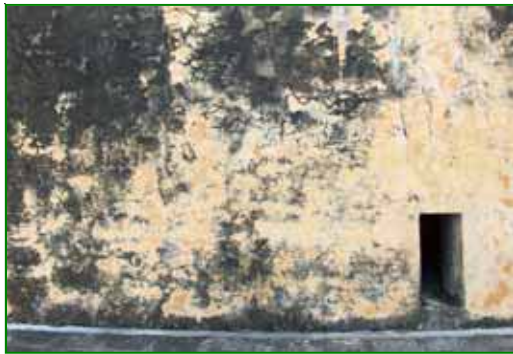
Vista del lienzo exterior del muro sur, de la cortina norte de la fortaleza de San Juan de Ulúa, donde se aprecia la acción de organismos parásitos sobre una reintegración contemporánea de aplanados.
